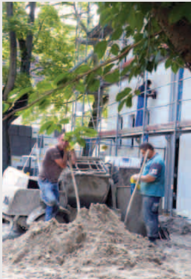
Lärm und Schmutz direkt unterm Fenster erfordert Geduld und Leidenschaft von den Hausbewohnern
